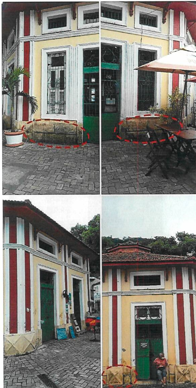
Fig. 06, 07, 08 e 09 – Imagens das fachadas, com foco nas machas de capilaridade. Fonte: INEPAC
