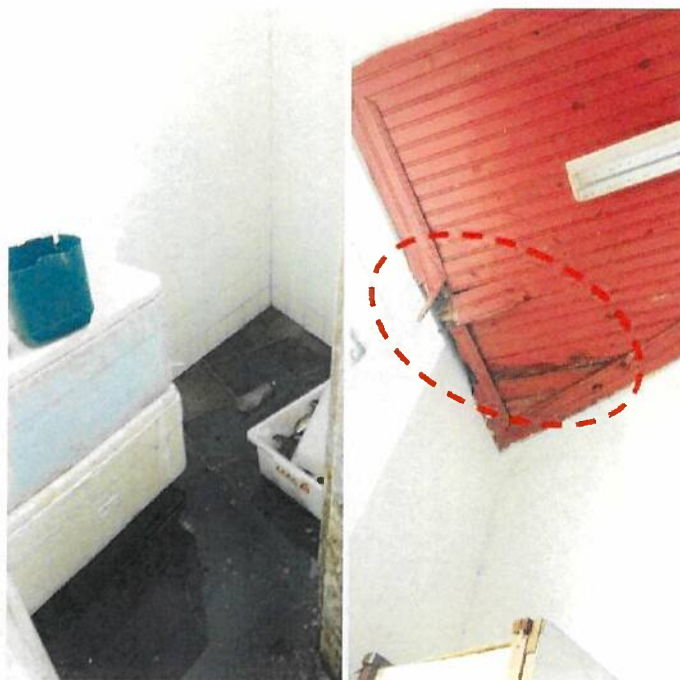
Fig. 53 e 54 – Imagens do depósito localizado do lado direito da entrada de serviço. Notam-se marcas de sujidade e umidade no portal de entrada, e danos no forro. Fonte: INEPAC
