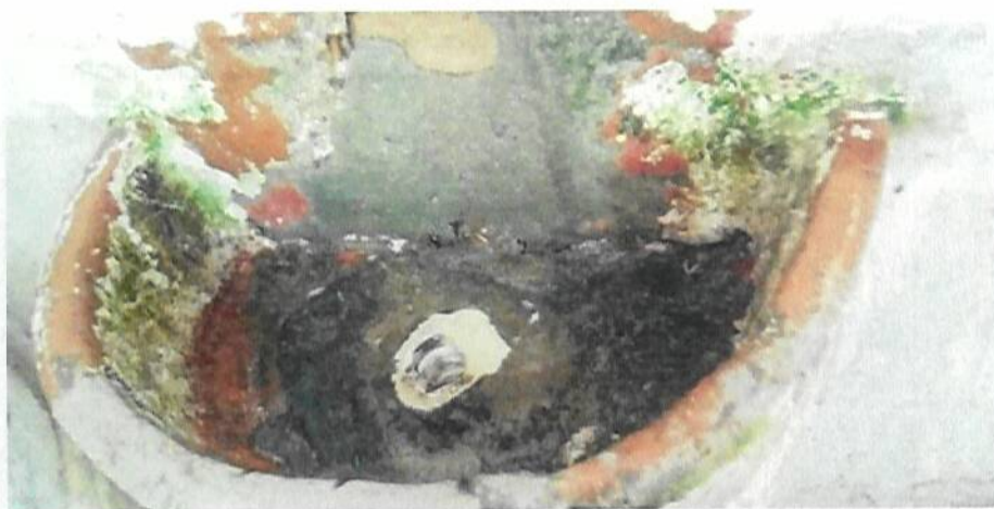
Fig. 50, 51 e 52 – Imagens do lavatório de serviço do mercado. Nota-se perda de argamassa, presença de umidade, formação de limo, e manchas de sujidades. Fonte: INEPAC
