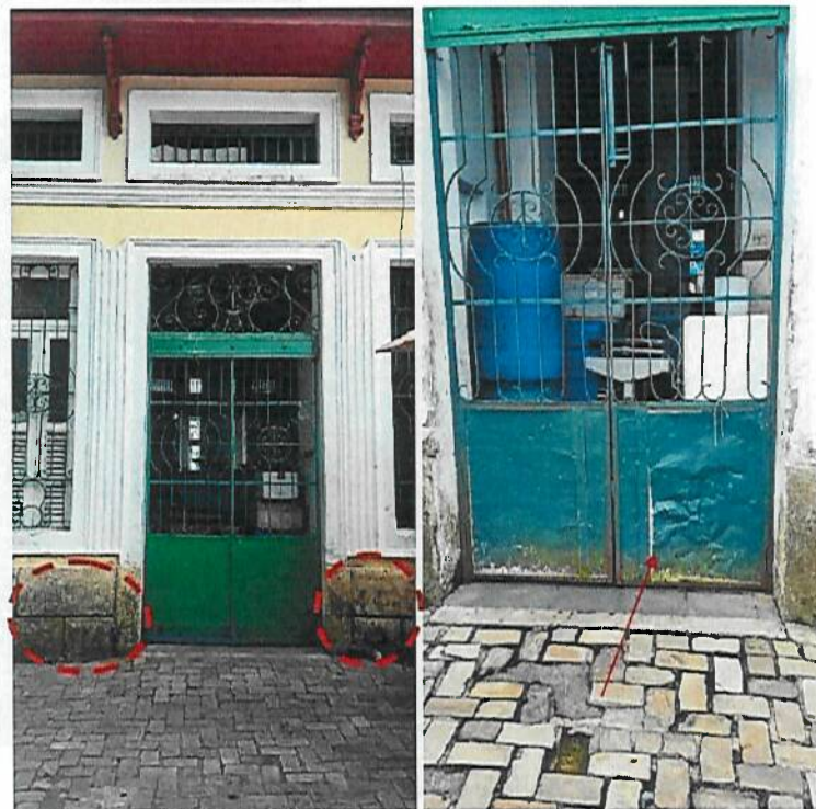
Fig. 28, 29, 30 e 31 – Imagens das portas da edificação, em detalhe as patologias encontradas. Fonte: INEPAC
