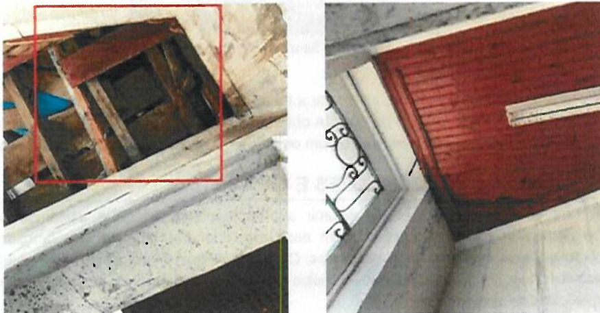
Figura 5 – Situação do forro do depósito
