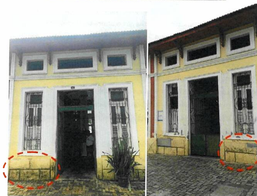
Fig. 03, 04 e 05 – Imagens das fachadas, com foco nas machas de capilaridade. Fonte: INEPAC
