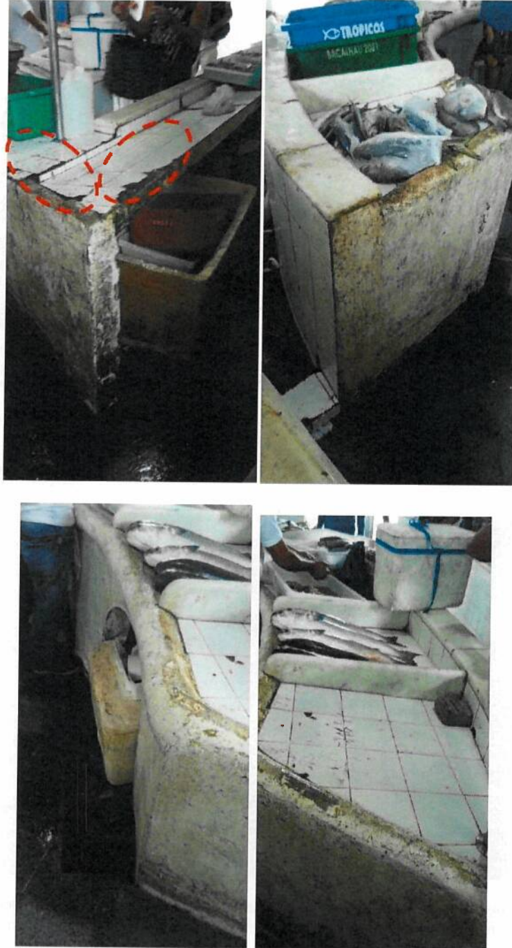
Fig. 46, 47, 48 e 49 – Imagens das bancadas do mercado. Nota-se que os azulejos estão quebrados, fissurados e com presença de lodo; e a alvenaria da base está com marcas de sujeira, umidade e lodo. Fonte: INEPAC
