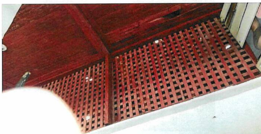
Fig. 62, 63 e 64 – Imagens do espaço colateral esquerdo da entrada de serviço, Nota-se manchas de umidades nas paredes, e avarias no forro e fechamentos. Fonte: INEPAC
