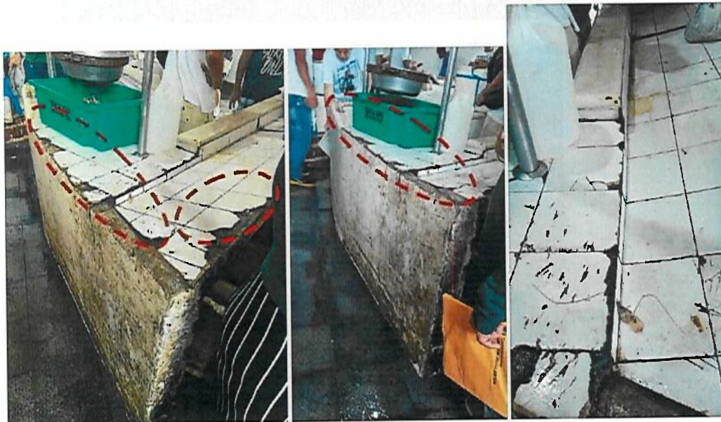
Fig. 43, 44 e 45 – Imagens dos azulejos deteriorados das bancadas do mercado. Nota-se que os azulejos estão quebrados, fissurados e com presença de limo; e a alvenaria da base está com marcas de sujidade e umidade. Fonte: INEPAC
