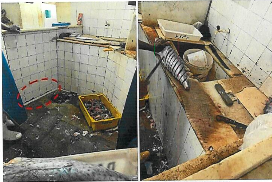
Fig. 41 e 42 – Imagens do ralo, da pia e do balcão da baía de limpeza dos peixes e avarias nos azulejos. Fonte: INEPAC
