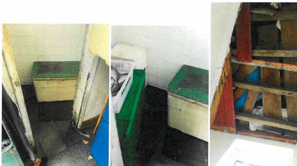
Fig. 55, 56 e 57 – Imagens do depósito localizado do lado esquerdo da entrada de serviço. Notam-se marcas de sujidade e umidade no portal de entrada, e lacunas no forro. Fonte: INEPAC
