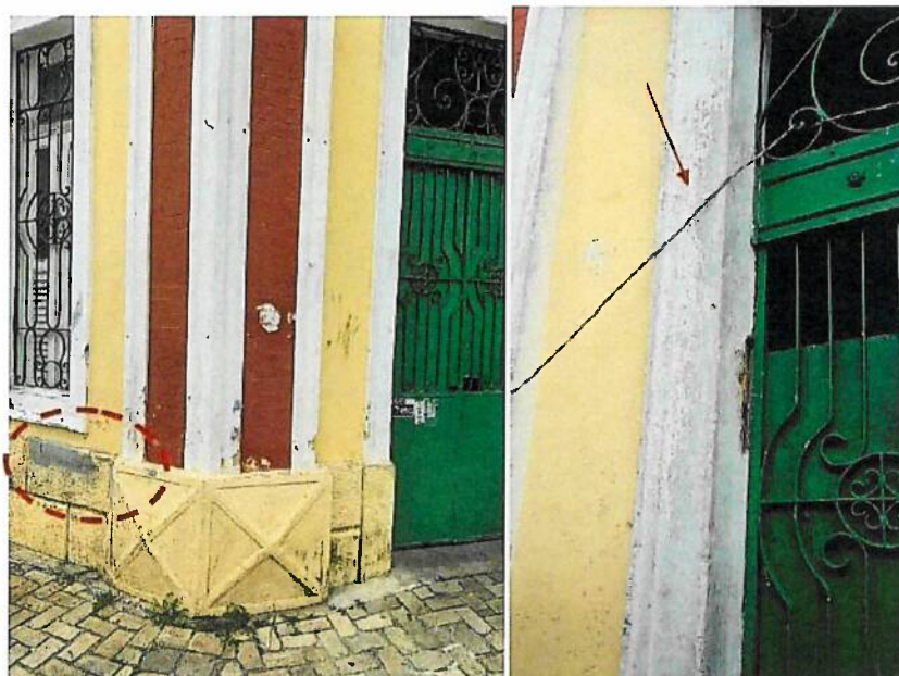
Fig. 24, 25, 26 e 27 – Imagens das fachadas, em detalhe as patologias encontradas no embasamento da edificação e fiação exposta. Fonte: INEPAC
