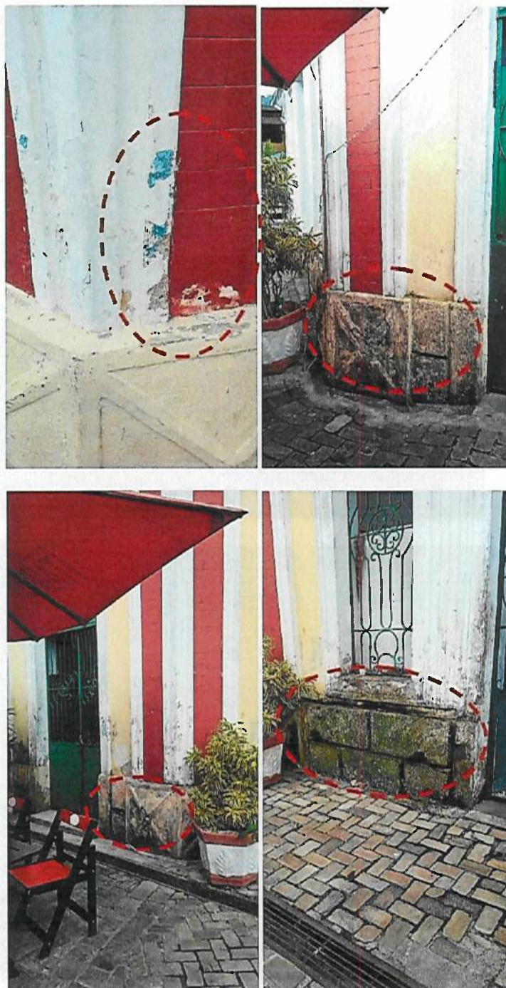
Fig. 20, 21, 22 e 23 – Imagens das fachadas, em detalhe as patologias encontradas no embasamento da edificação. Fonte: INEPAC
