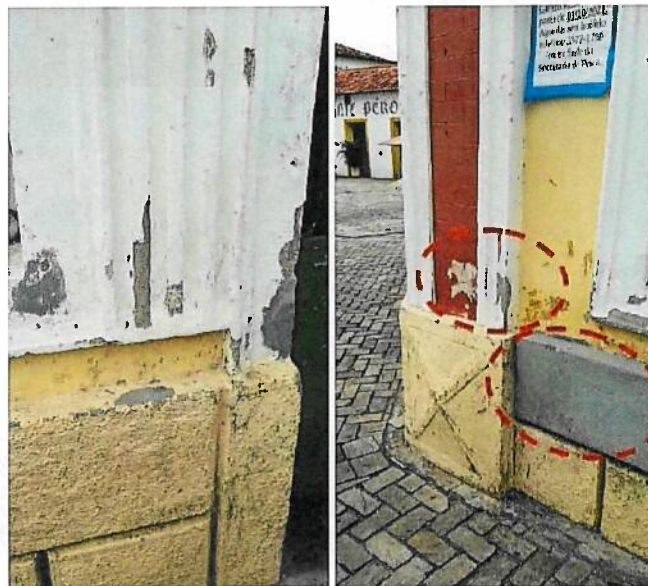
Fig. 16, 17, 18 e 19 – imagens das fachadas, em detalhe as patologias encontradas no embasamento da edificação. Fonte: INEPAC
